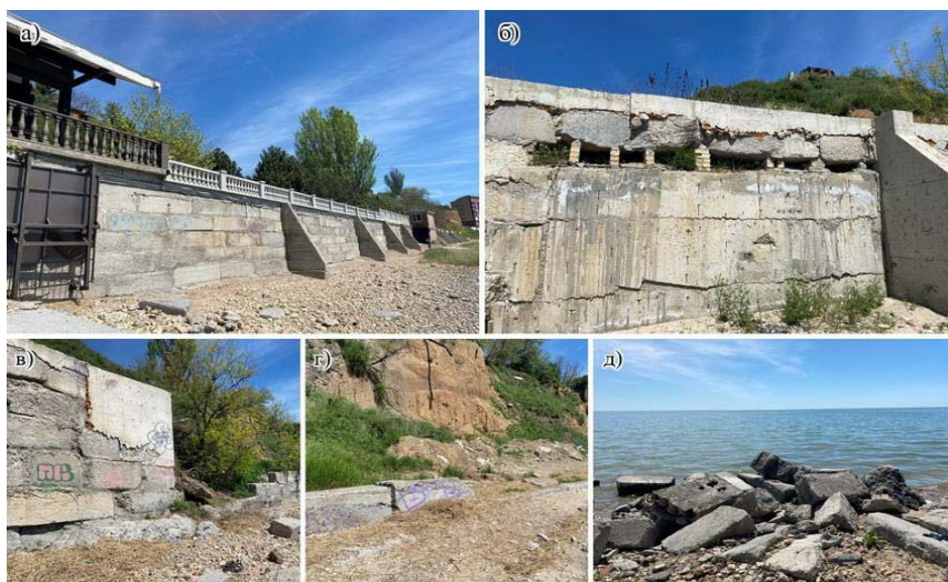
Рисунок 2. Состояние волноотбойной бетонной стенки в г. Таганрог: а – общий вид; б – разрушающийся участок; в – крайняя восточная часть стенки; г – окончание, представленное бетонными одноблочными плитами; д – пляж
