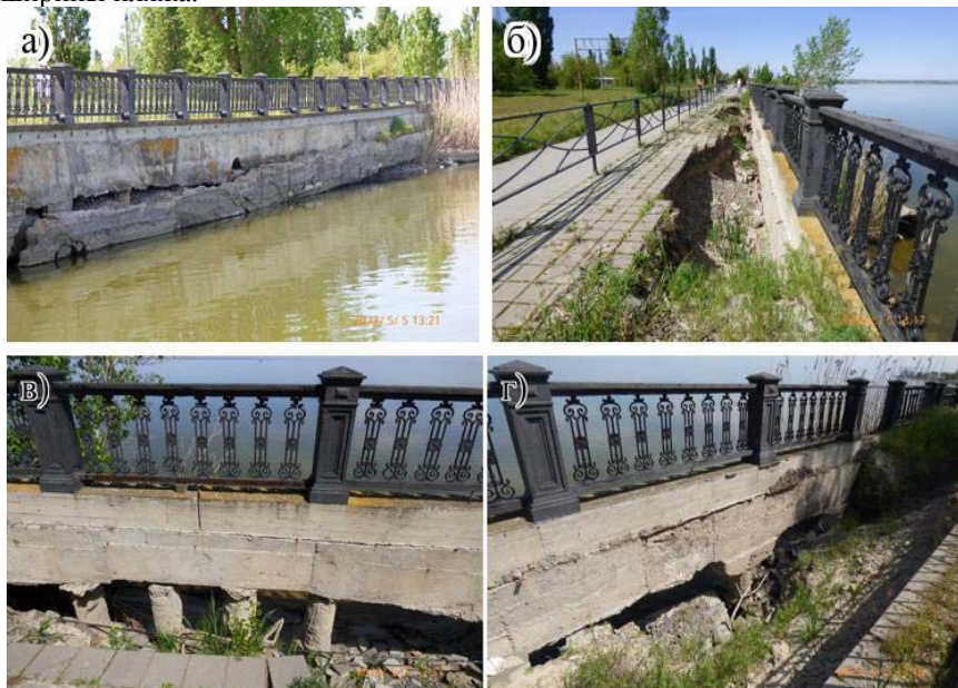
Рисунок 3. Волноотбойная стенка реконструированной части Пушкинской набережной, г. Таганрог: а – общий вид просадки; б–г – аварийные участки на променаде
